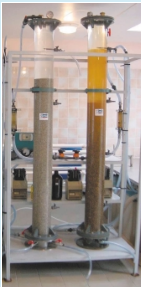
Pilote de filtration biologique pour la rétention de l'arsenic - Photo : IRH
