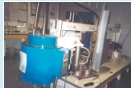
Four carbonisation et unité de traitement des gaz Photo : Ecole des Mines de Nantes
