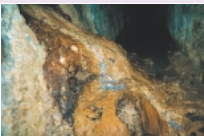
Dépôts métalliques (Cu, Zn) sur les parois du tunnel de la mine de Chessy (69) - Photo : ECP/BRGM
