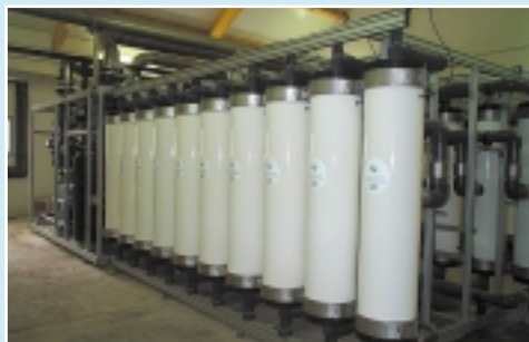
Bloc d'ultrafiltration, usine de La Viadère, Aveyron Photo : Ondeo Degrémont
